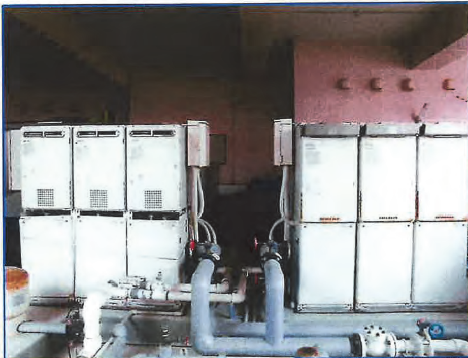
No.1 系統(ガス給湯器 6 台)
